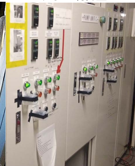
チラー制御盤
