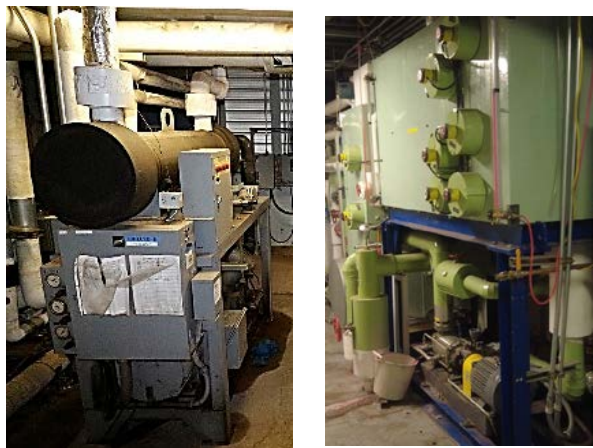
チラー 送水ポンプ・タンク
