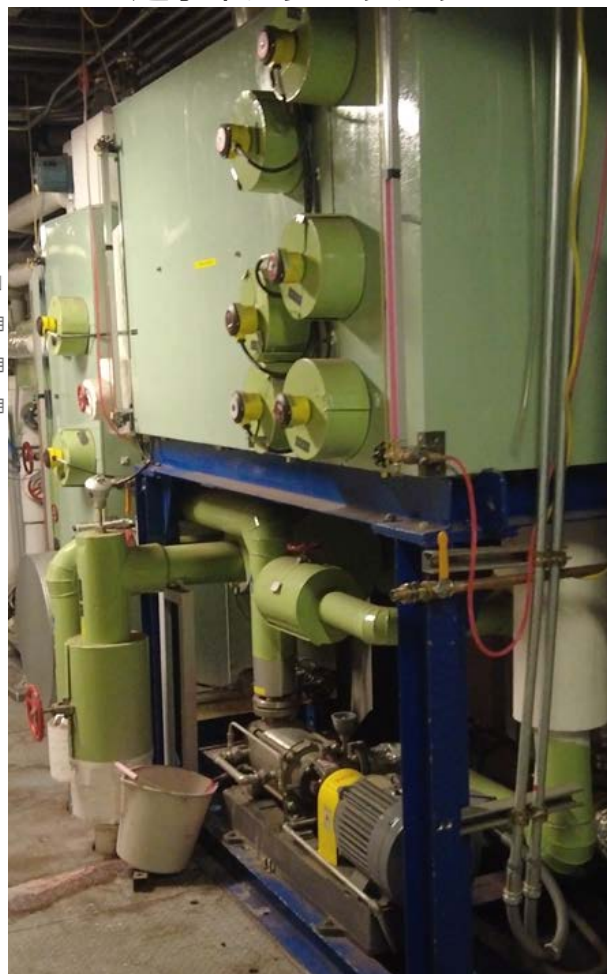
送水ポンプ・タンク
